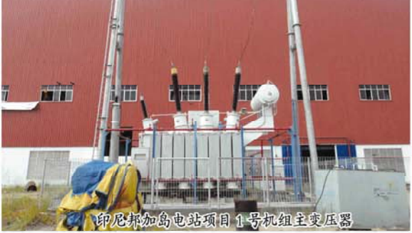
印尼邦加岛电站项目1号机组主变压器
